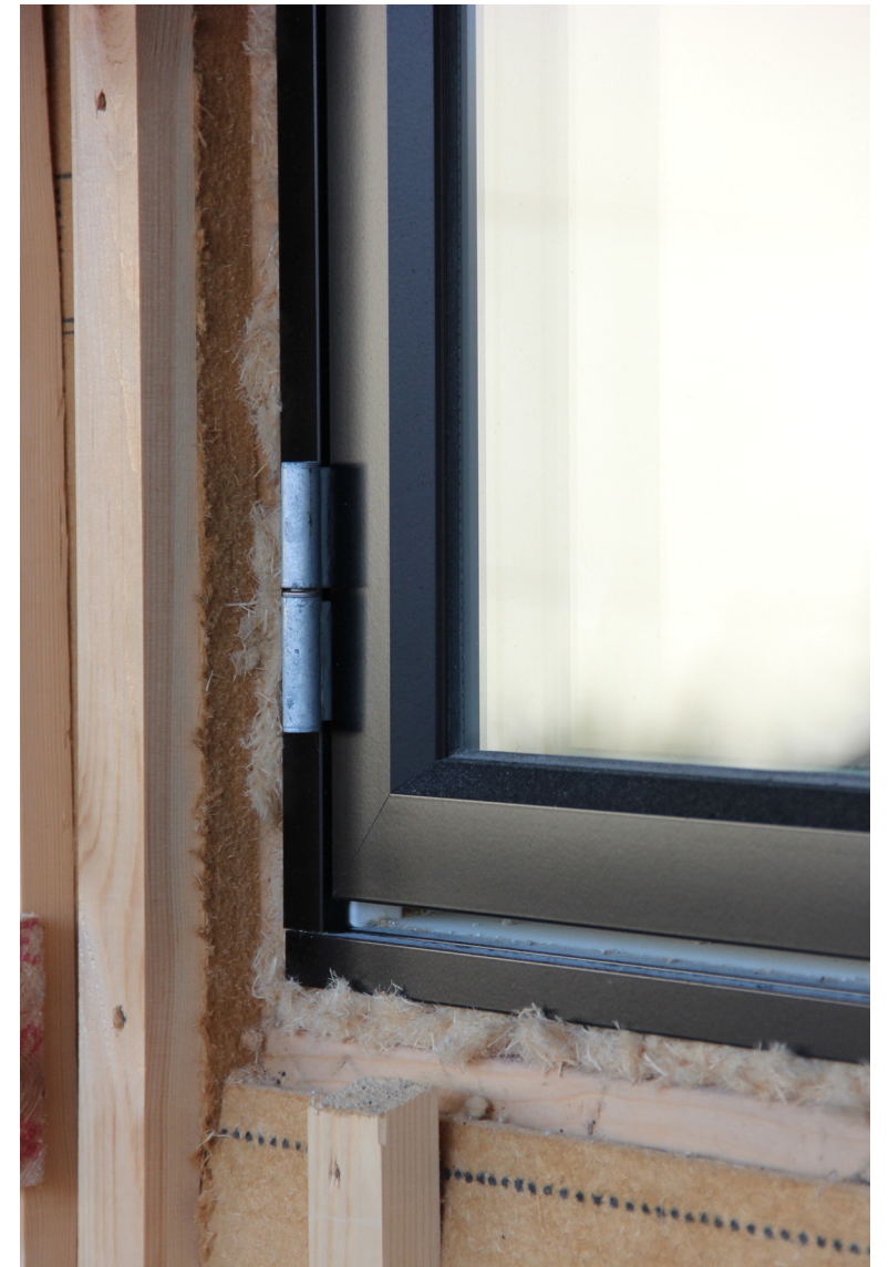
Som isolering er der brugt træfiberisolering, så man ikke behøver at bruge dampspærre.
