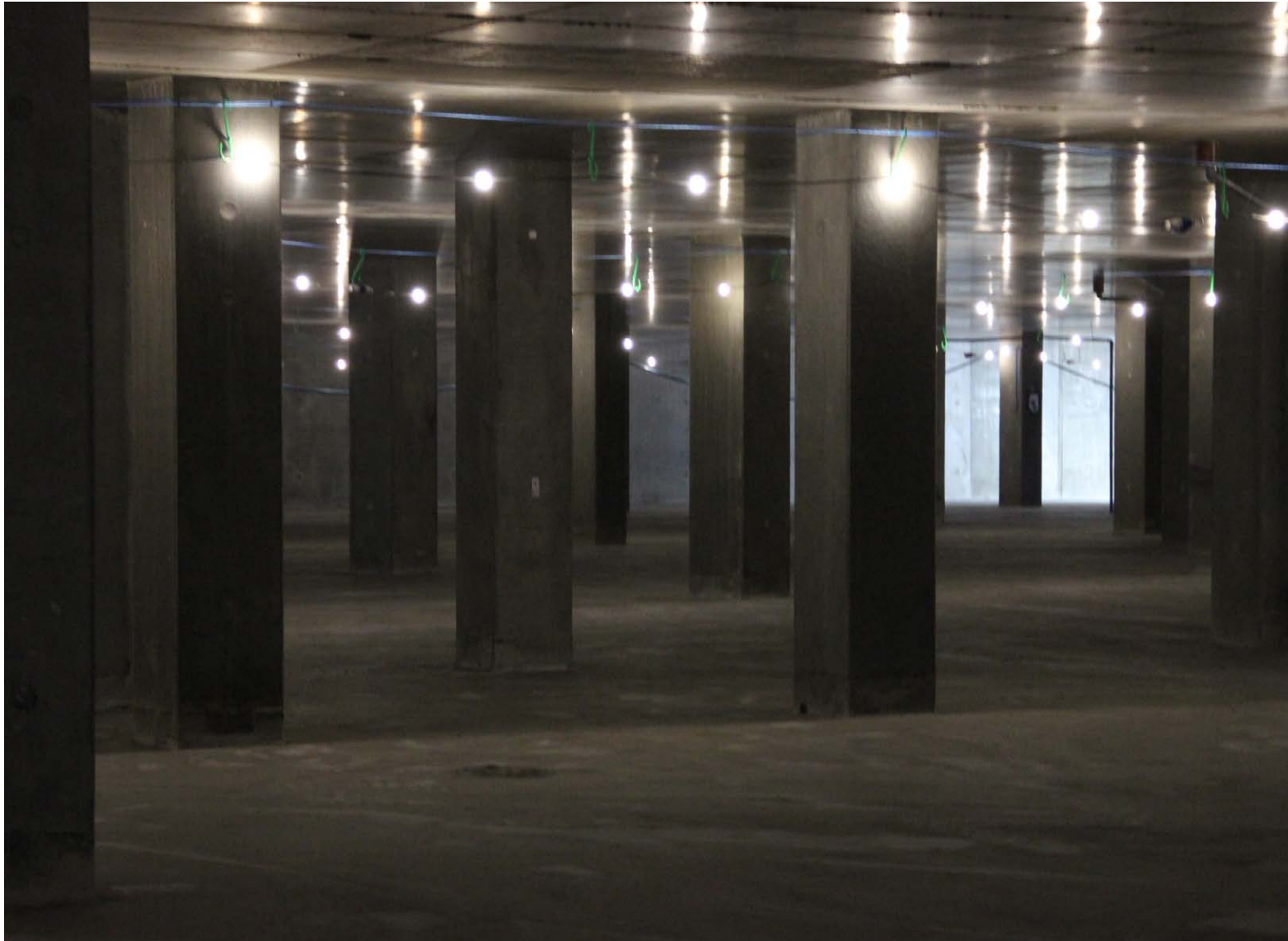
Danske Banks hovedsæde er første etape af byggeriet i Postbyen. Her er flot kig blandt de mange betonsøjler i parkeringskælderen. Der er afsat 40.000 m2 til parkering og teknik.
